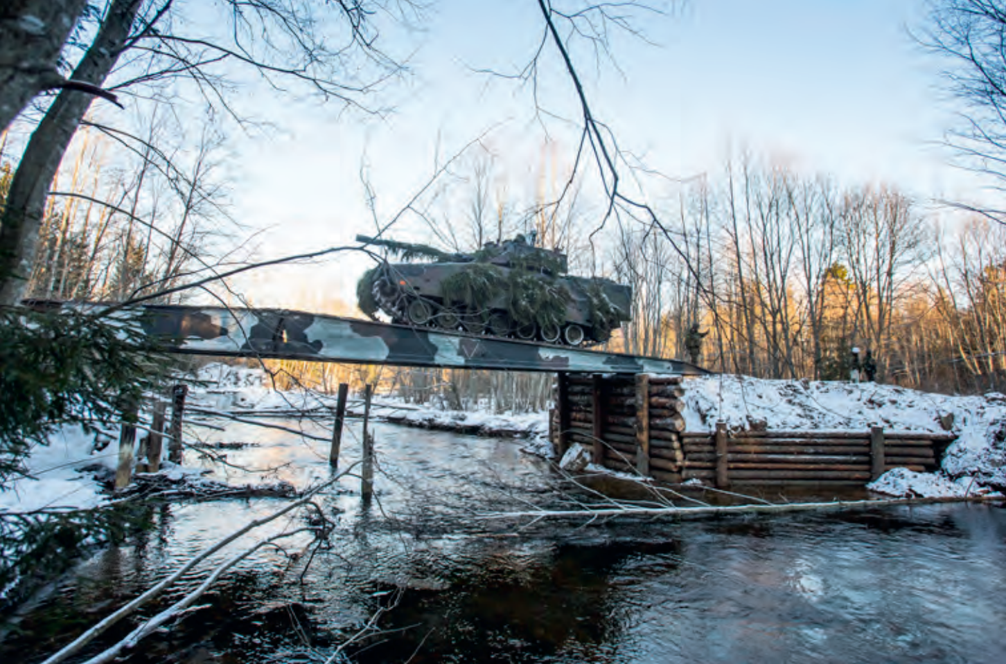
Oefening in Estland. Constructiegenie, zoals bruggenbouw, draagt direct bij aan het bouwen van vertrouwen van de Oost-Europese landen in Nederland als bondgenoot
